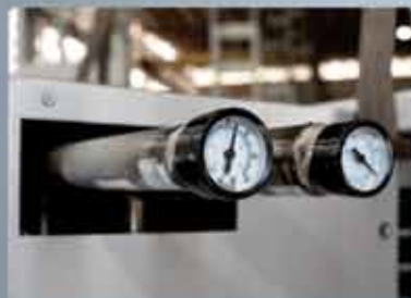
Equipamentos pressurizados com N2 e enviados com manômetros.
