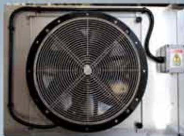
Caixa de passagem e eletrodutos IP66 de acordo com NBR 5410. Grade de proteção do ventilador em inox.
