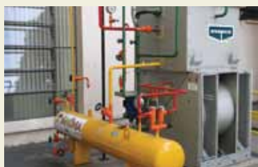
Instalação de Amônia
