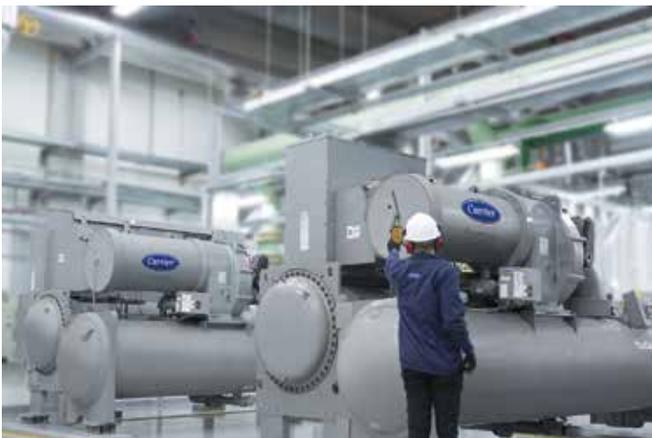
Manutenção regular aumenta o tempo de vida dos equipamentos
