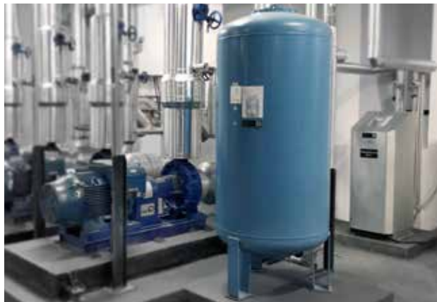
Tanque e sistema de desgaseificação da linha
