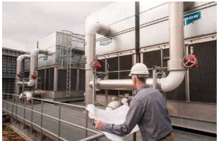
Qualidade da água é fundamental para as torres de resfriamento
